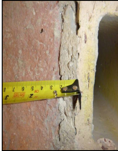
Ilustración 21. Detalle mortero de pega en los muros (CASA 2).
