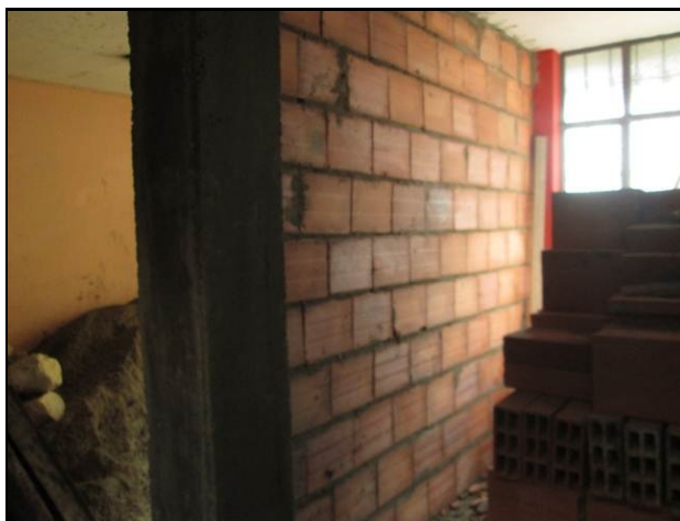
Ilustración 9. Detalle mortero de pega en los muros (CASA 1).
