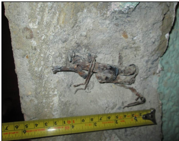
Ilustración 8. Detalle concreto a la vista en la vivienda (CASA 1).
