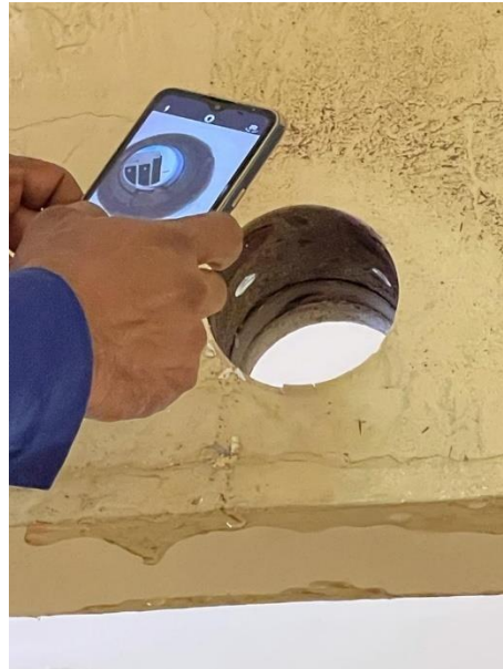
IMAGEN 4 ESTADO ACTUAL DE LA VIGA DONDE SE APRECIA LA PRESENCIA UNA VARILLA DE REFUERZO SUPERIOR
