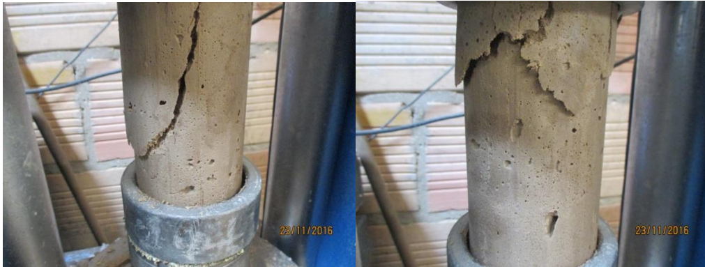
Ilustración 10. Ejemplo de falla numero 5
