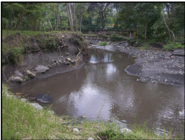
Acumulación de sedimentos y montículo socavado
