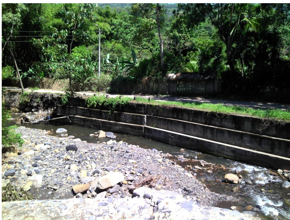
Fotografía 2. Muro de contención en riesgo de colapso. Fuente propia
