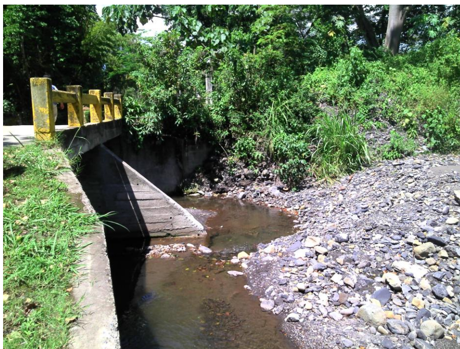
Fotografía 2. Acumulación de sedimentos al frente de la estructura evitado su funcionalidad. Fuente propia
