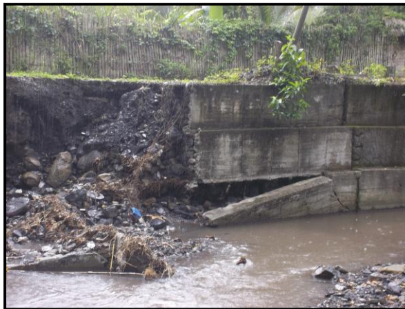
Muro en riesgo de colapso
