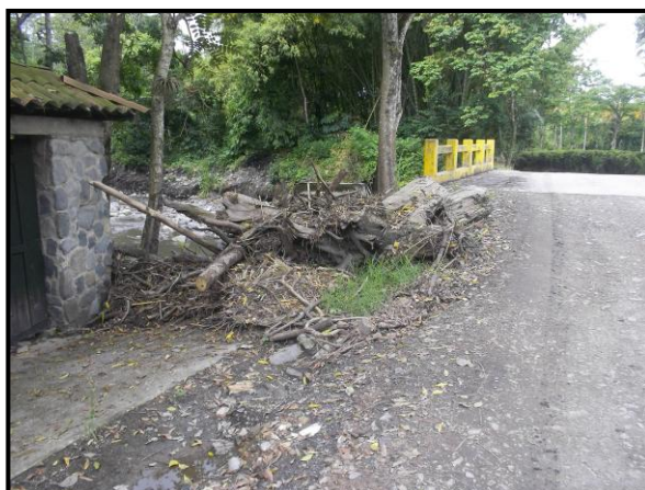
Acumulación de material de arrastre
