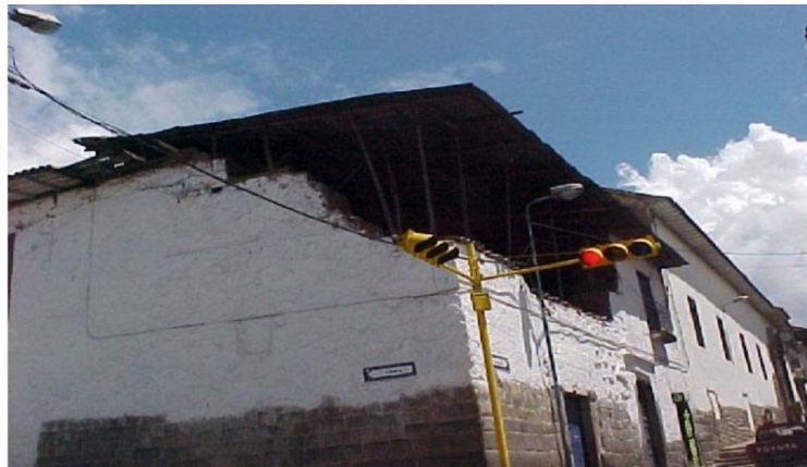
Ilustración 8 grietas en las esquinas
