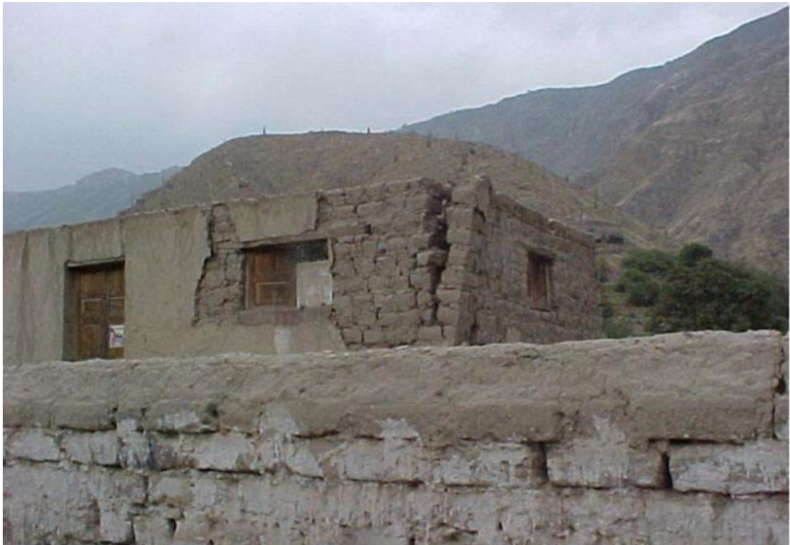
Ilustración 3 grietas verticales en las esquinas
