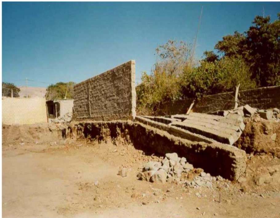
Ilustración 4 grietas por flexión fuera del plano
