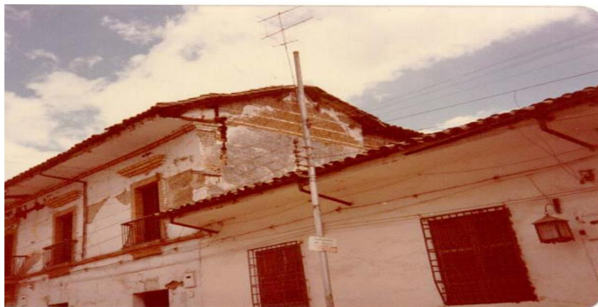
Ilustración 2. inicio de grieta en tímpanos o culatas
