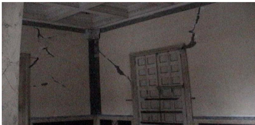
Ilustración 7 grietas cerca de los vanos
