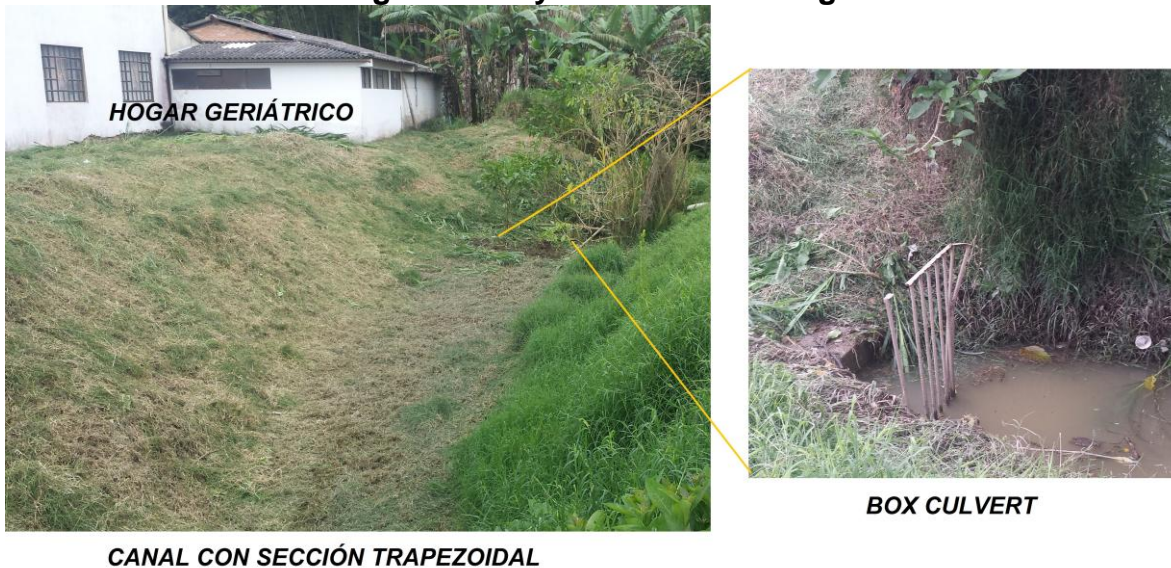
Imagen 1. Primer punto, represamiento de aguas por taponamiento del box Culvert. Hogar geriátrico ubicado en zona de ronda.
