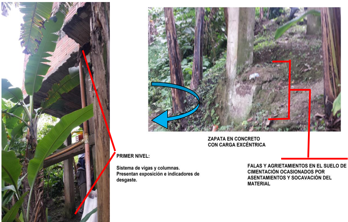
Imagen 4. Cuarto Punto, vivienda en riesgo de colapso por fallas y exposición de la cimentación. Socavación y asentamientos.
