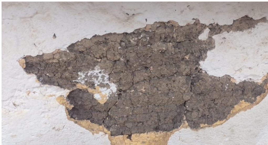
Figura 18 Muro externo patología desprendimiento de repellado
