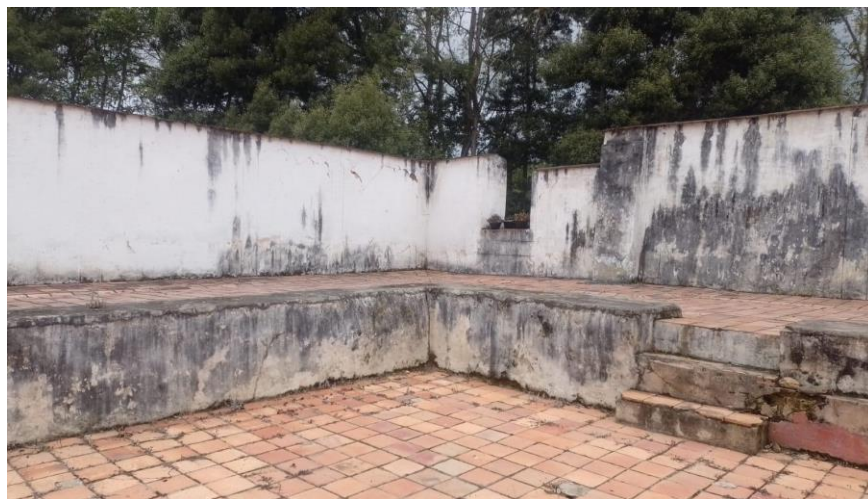
Figura 20 Muro interno patología
