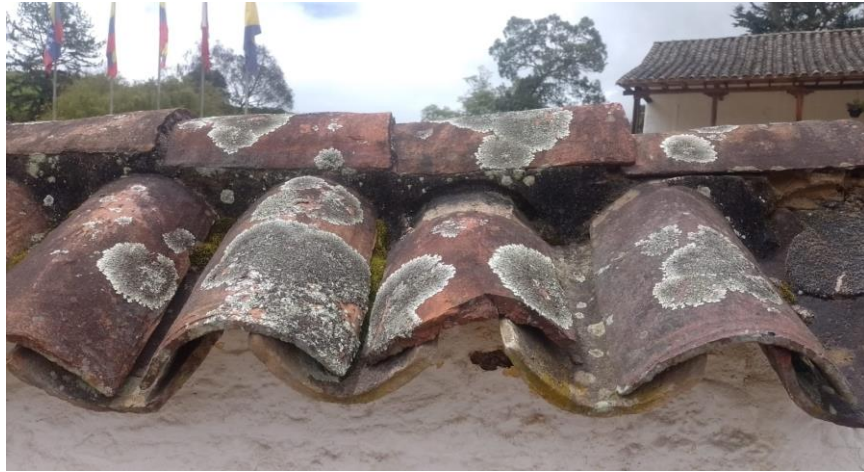
Figura 19 Muro externo patología cubierta
