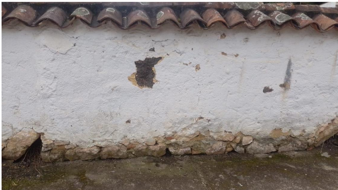
Figura 17 Muro externo patología
