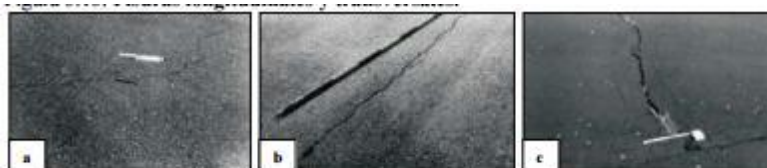
Fisuras de niveles de severidad bajo (a), medio (b) y alto (c).
