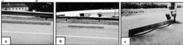
Corrugación de nivel de severidad bajo (a), medio (b) y alto (c).
