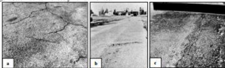
Abultamientos y hundimientos de niveles de severidad bajo (a), medio (b) y alto (c).
