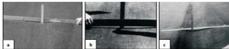
Ahuellamiento de nivel de severidad bajo (a), medio (b) y alto (c).
