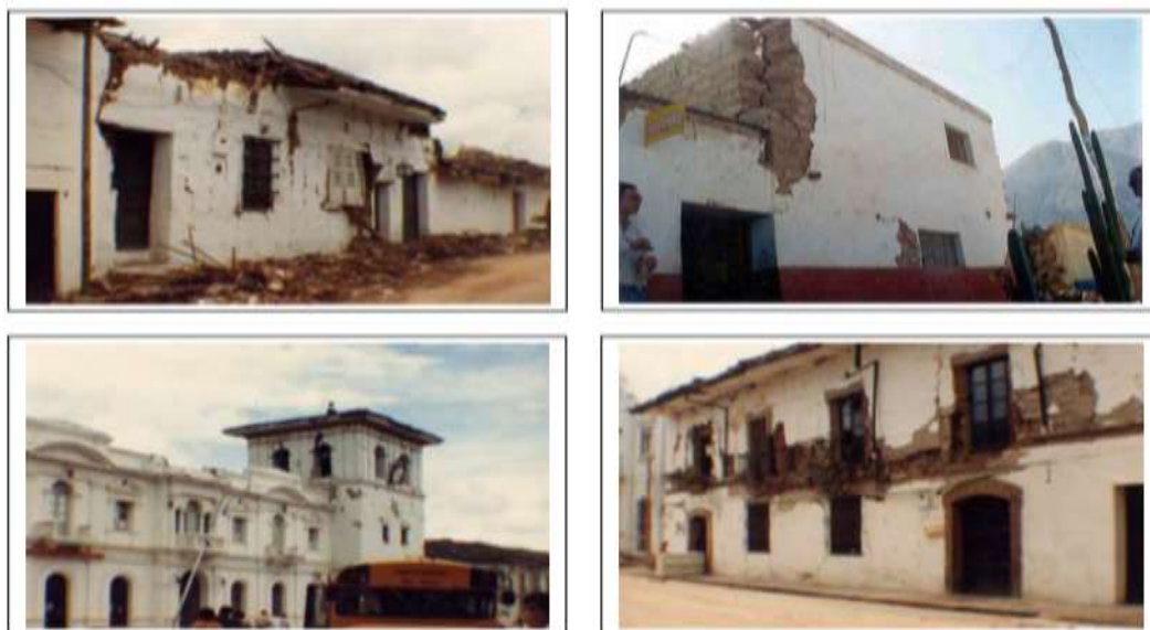
Figura 16. Daños sísmicos de las edificaciones en tierra; tomado de Asociación Colombiana de Ingeniería Sísmica – AIS (s.f) https://upload.wikimedia.org
