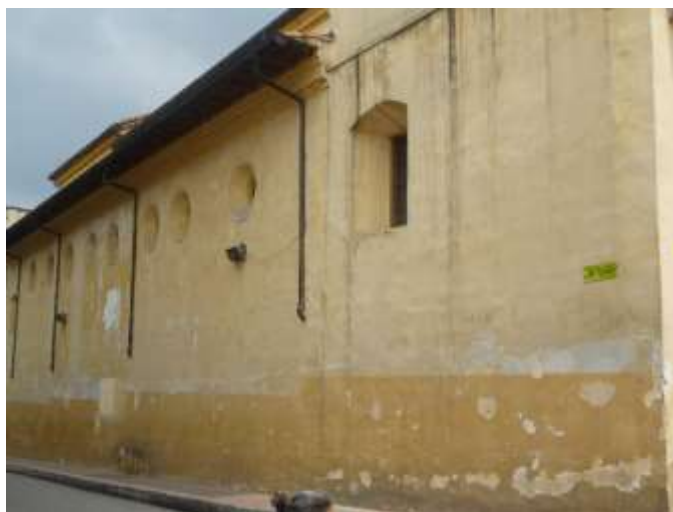
Figura 12. Iglesia de la Candelaria Daños por Humedad; Elaboración propia
