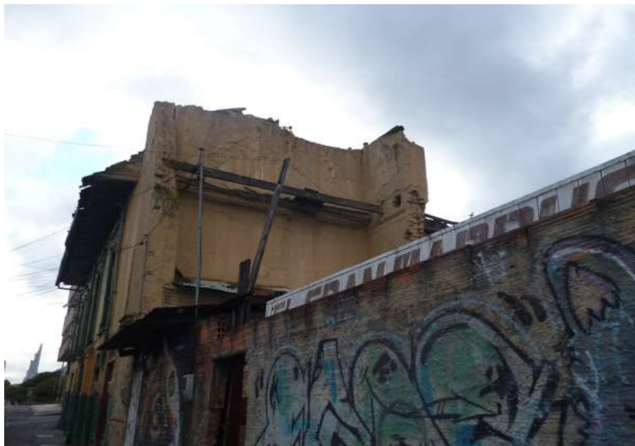
Figura 14. Desgaste fachado lateral por filtración de agua, elaboración propia
