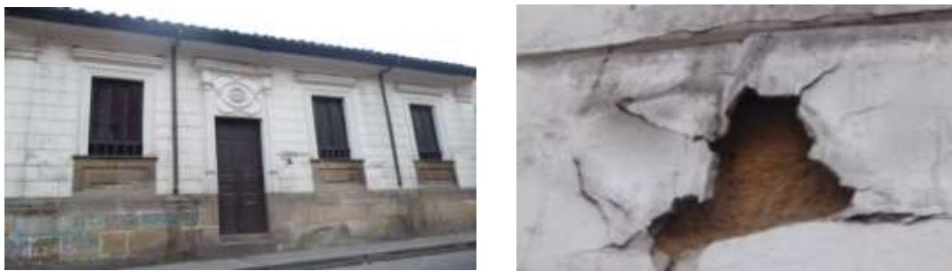
Figura 22. Erosión del material en fachada localidad la candelaria; elaboración propia.
