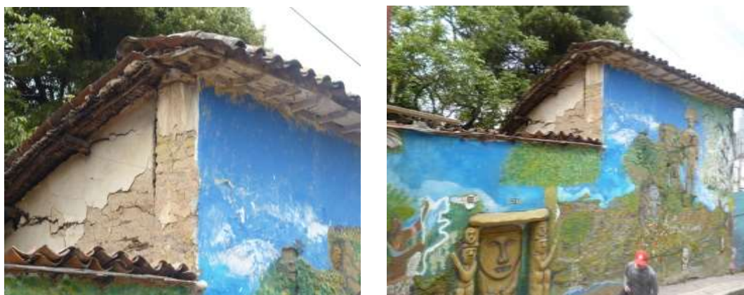
Figura 23. Desprendimiento del material La Candelaria, Elaboración propia
