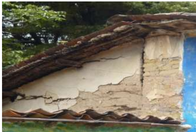
Figura 11. Daño por humedad (Falla del Material); Elaboración propia
