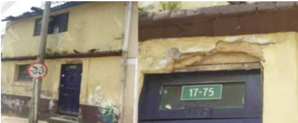
Figura 5 Patologías por Humedad
