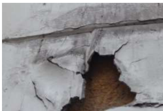
Figura 10. Daño por humedad desprendimiento del Material; Elaboración propia
