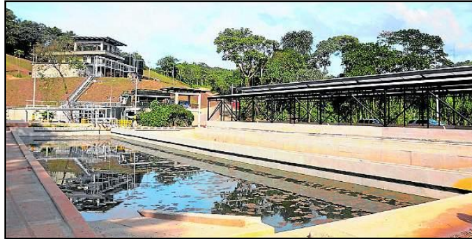
Imagen 5. Planta para tratamiento de lixiviados Medellín
