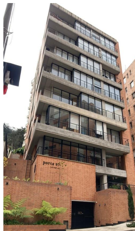
Figura 3 Afectación del agua en los bordes de placa frontales del edificio Porta 87
