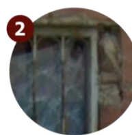
Corrosión por exposición
