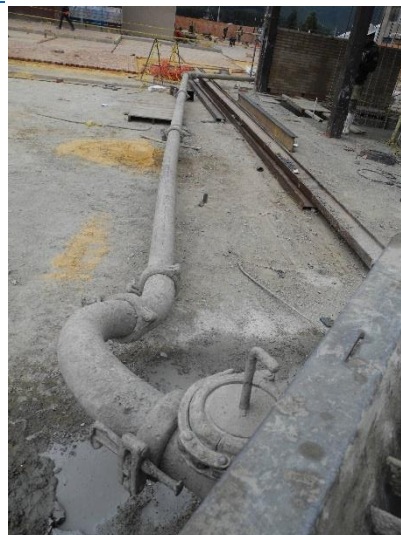
Ilustración 13: Tubería de bombeo.
