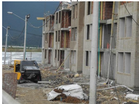
Ilustración 2:Equipo de bombeo
