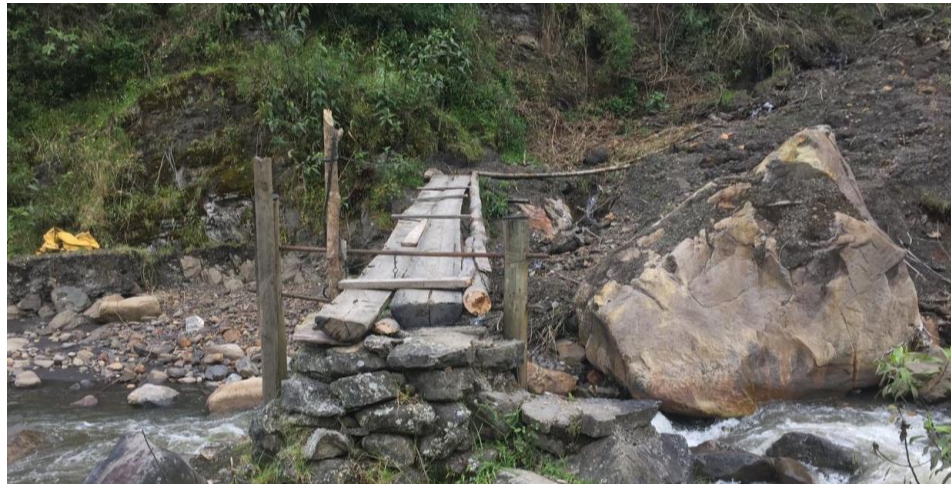
Figura 10. Puente peatonal artesanal ubicado en una zona crítica de deslizamiento.
