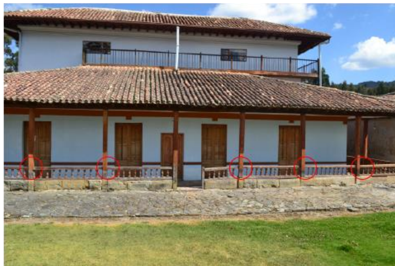
Figura 29. Lesión en madera Hacienda El Hato. Fotografía Hernández, K (2019) Humedad por capilaridad y envejecimiento.
