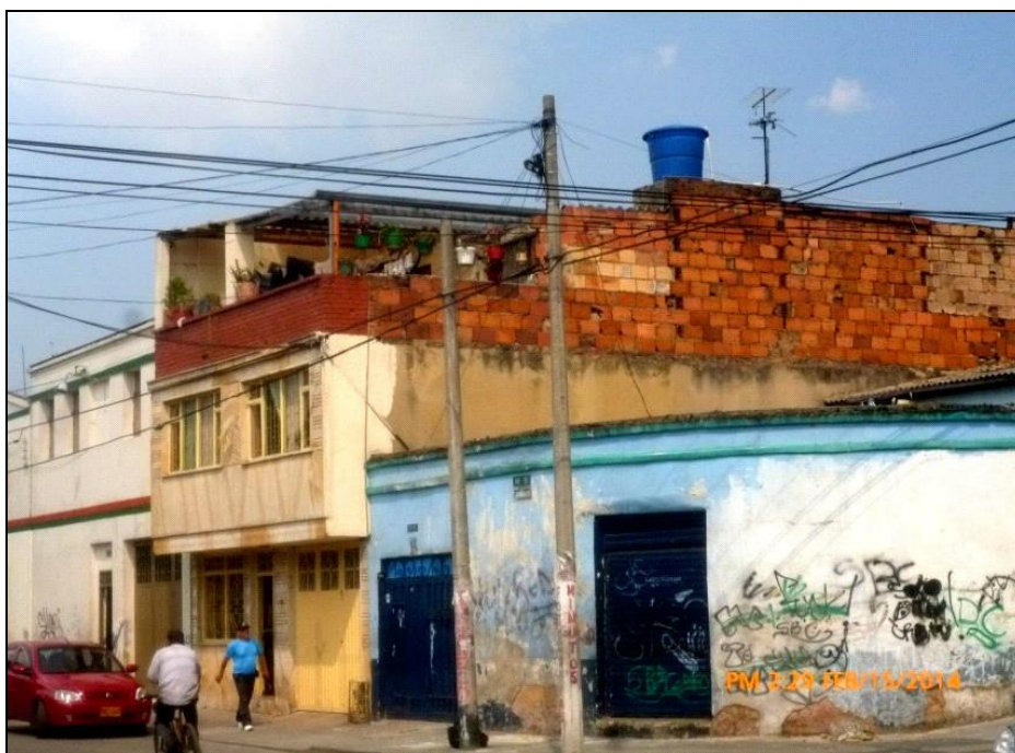
Figura 5. Las edificaciones no cumplen con la norma NSR-10.
