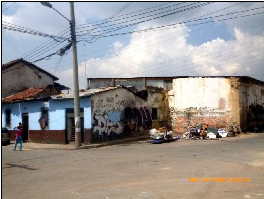
Figura 3. Deterioro en las edificaciones.
