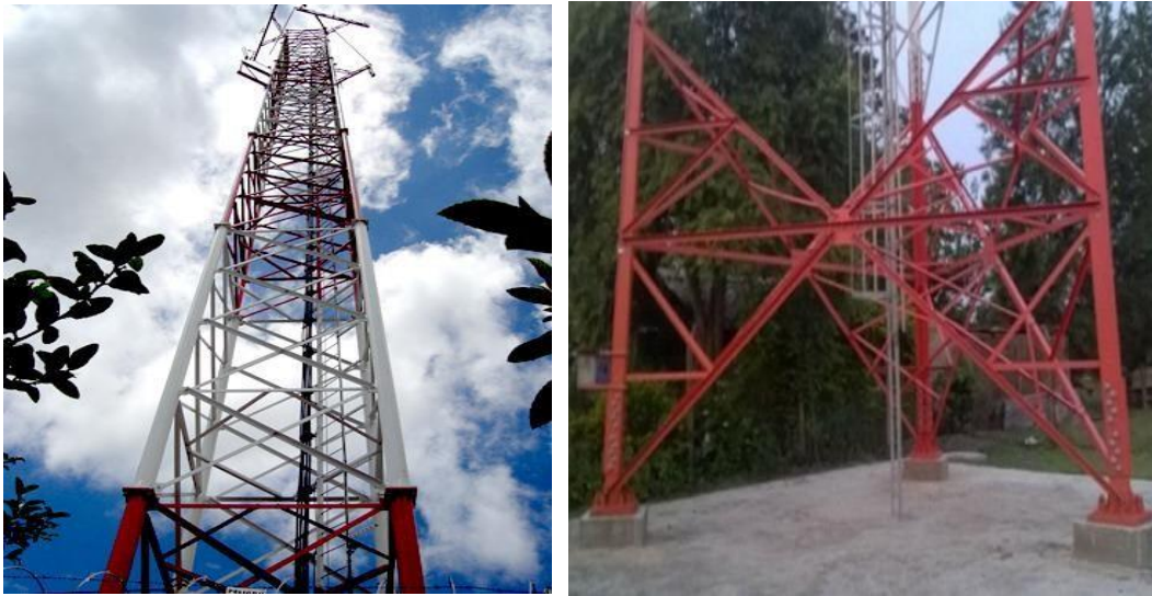
Figura 5. Estructura metálica y cimentación torre auto soportada.
