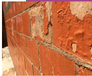
Cripto eflorescencia no visible
