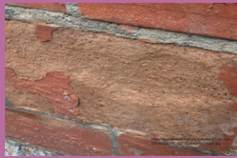
FALLO POR CRIPTO EFLORESCENCIA
