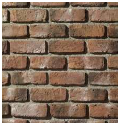
Figura 46 Suciedad en la superficie del ladrillo
