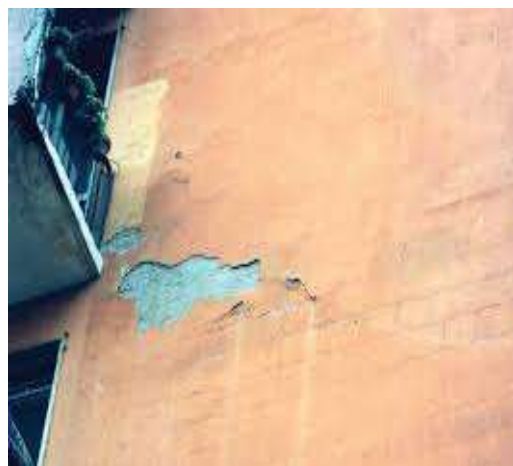
Figura 47 Desprendimiento del revestimiento
