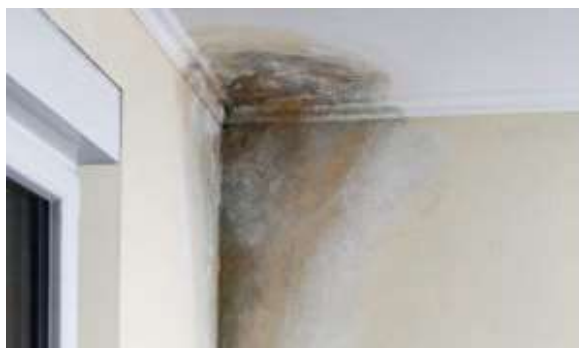
Figura 50 – Pared con Humedad por filtración
