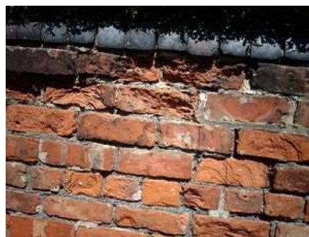
Figura 49 - Erosión del material
