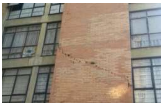
Figura 48 - Fisuras por Cargas
