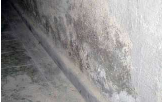
Figura 51 – Humedad por capilaridad
