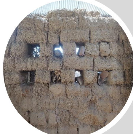
DESPRENDIMIENTO POR ELEMENTO
