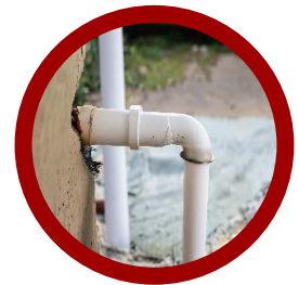
4. FUGA DE TUBERÍAS
