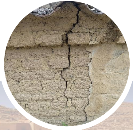
GRIETAS Y FISURAS
