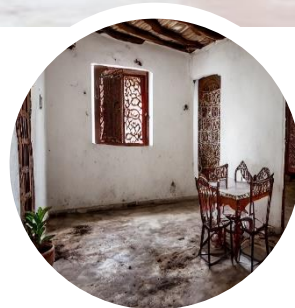
FALTA DE MANTENIMIENTO
