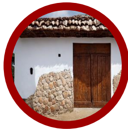
2. AUSENCA DE PROTECCIÓN
