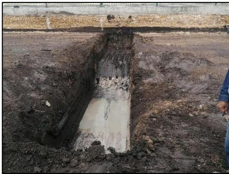
Figura 54 Fallos Fuente propia
