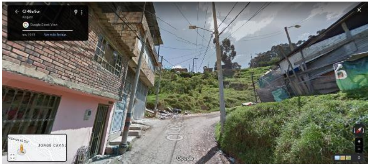
Figura 19. Vivienda en riesgo de desplome UPZ 53
