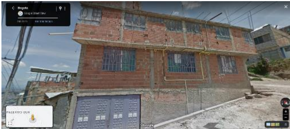
Figura 36. Sistema de tubería doméstica
