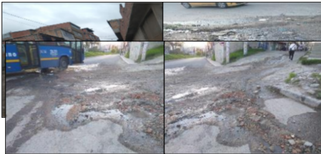
Propia Figura 29. Dispersión de Aguas residuales en vías públicas
