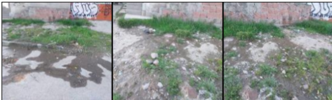
Filtraciones de aguas residuales desde las viviendas.
