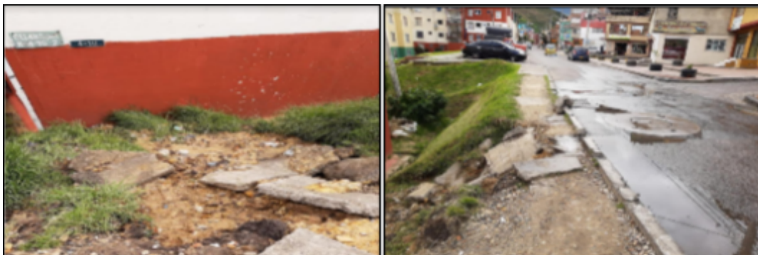
Figura 15. Deslizamiento de tierra en el Jarillón de una de las torres de los apartamentos del sector de molinos II.
