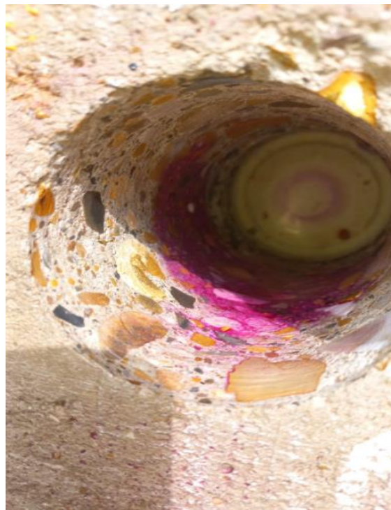
Figura 14. Frente de carbonatación, edificio D.
