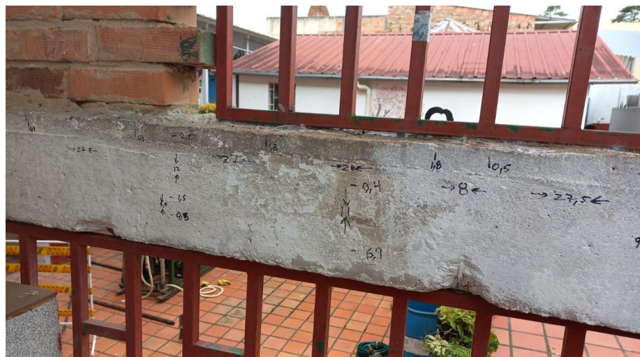
Figura 16. Acero expuesto en edificio B.
