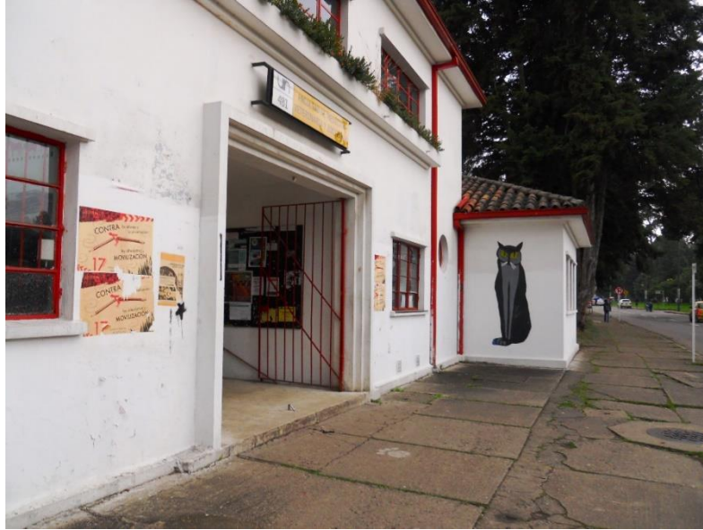
Figura 1. Acceso principal facultad de Zootecnia Universidad Nacional de Colombia En la imagen se evidencia el mal estado de la infraestructura, además de esto es notorio que el acceso no tiene la capacidad para recibir la cantidad de estudiantes necesaria Tomado de: ( https://unal.edu.co/la-universidad/recorrido-virtual/panoramica/?tx_ttnews%5Btt_news%5D=285&cHash=6ba876344a391c0dce4d3c61d18a843a ).
