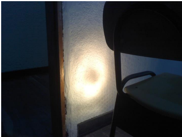
Muro de concreto expuesto al calor
