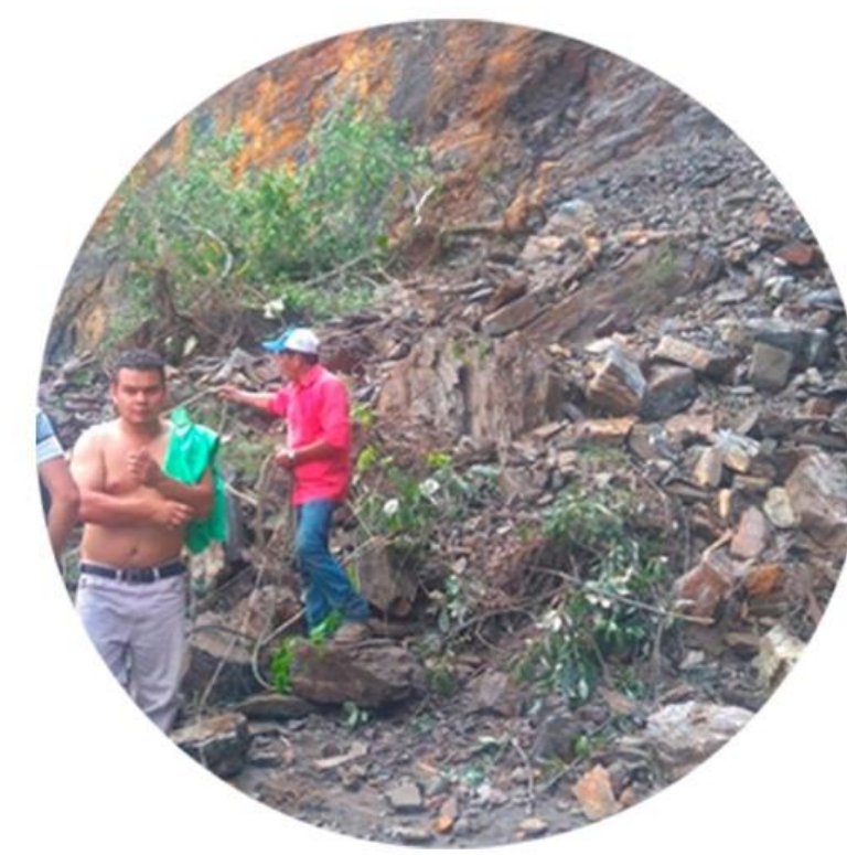
4 Derrumbes en vía Principal La Palma - Bogotá
