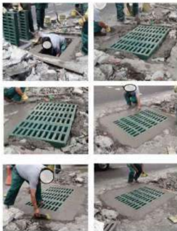
Alcantarillado en rejilla plástica
