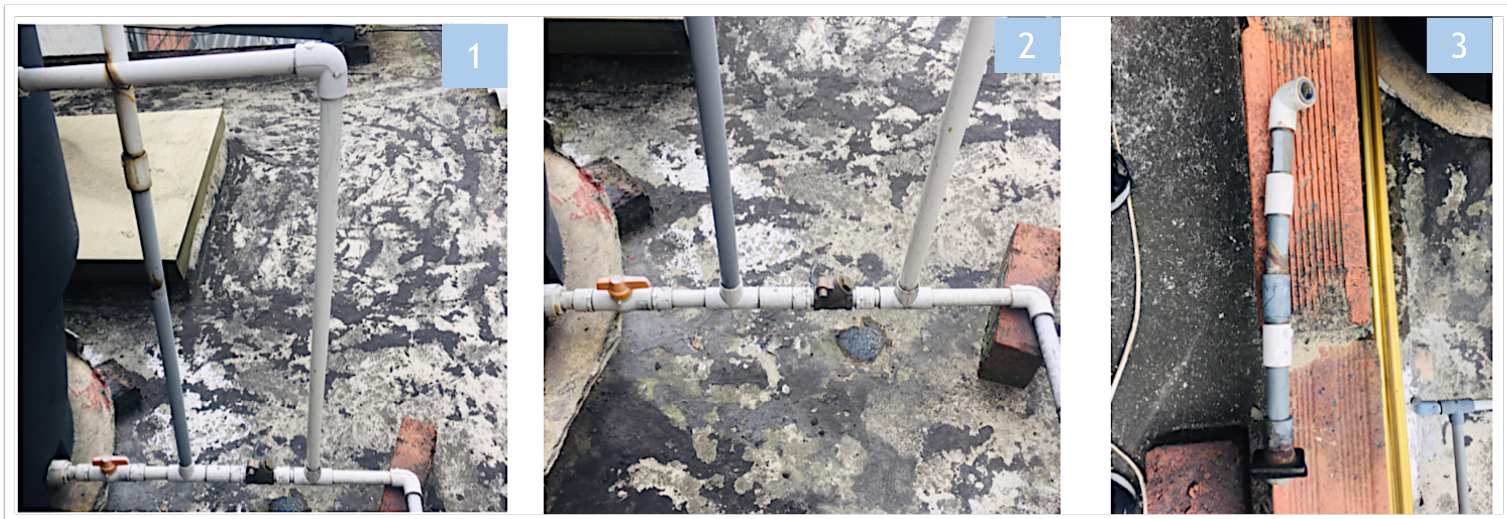
EVIDENCIAS DE PATOLOGIAS EN VIVIENDA CON TUBERIA DE PVC EXPUESTA UBICADA EN LA CALLE 20 C 12 47 ESTE , BOGOTA
