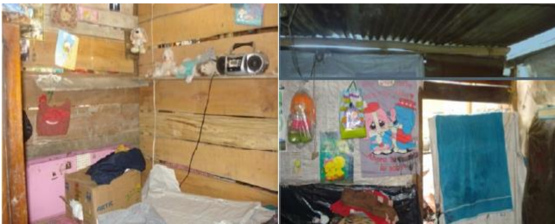
Figura 8. Vivienda en déficit cualitativo de muros. Tomado de: Montero, 2013. Referencia: “Diseño de un sistema de muros divisorios de bajo costo” por O. Montero, 2013, p.34. Recuperado de https://bit.ly/2MF5dw4
