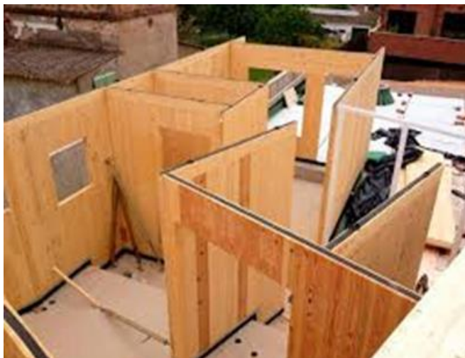
Figura 13. Construcción de una casa ecológica. Tomado de: Slowhome, 2016. Referencia: “Construir una casa ecológica prefabricada” por Slowhome, 2016. Recuperado de https://bit.ly/2XFRf34
