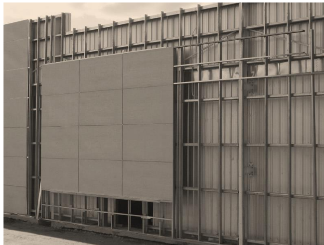
Figura 55. Sistema de muros en superboard. Tomado de “Como hacer una placa de fibrocemento”, Recuperado de https://www.etsnitconstruccion.com.ar/es-es/soluciones-etsnit/articulos/como-hacer-una-pared-con-placa-de-fibrocemento
