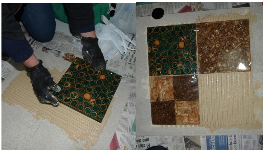
Figura 31 Instalación del azulejo. El prototipo logra adaptarse bien a la pega gracias a la malla de fibra de vidrio que posteriormente se le instaló en una de sus caras. También se le agregaron separadores para que la junta de dilatación fuese igual en todos sus lados y lograra un emboquillado adecuado. Elaboración propia.
