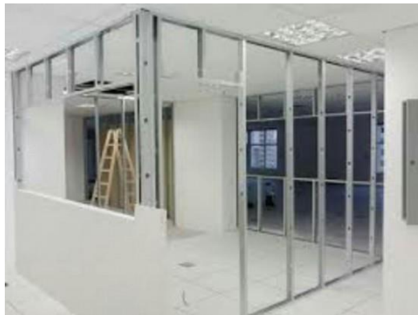
Figura 5 Detalle estructura muros divisorios de drywall. Tomado de Drywall y Techos Supernoard, 2012.
