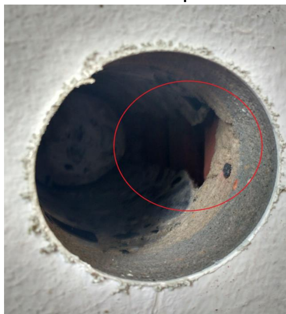
Figura 24. Evidencia N° 1 mampostería en columna
