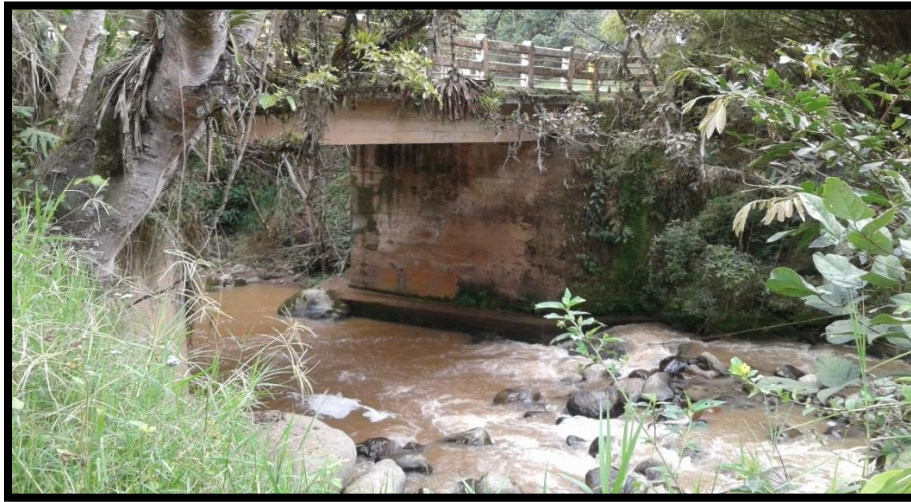
Ilustración 1, Erosión Puesto San Bernardo
