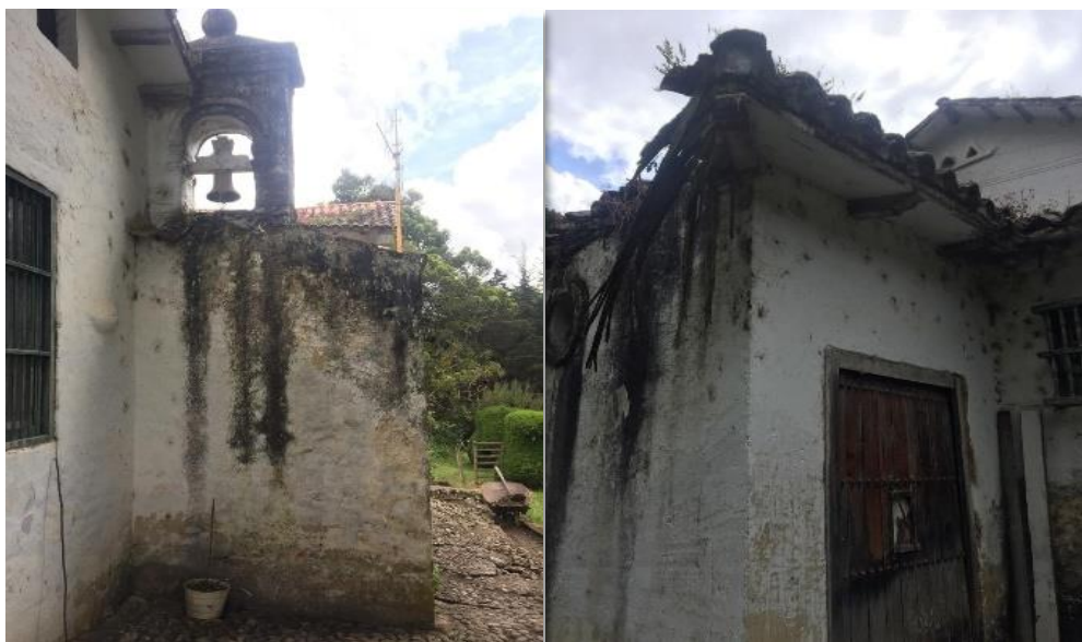
Imagen 2-2: Deterioro físico de la casa de operaciones
