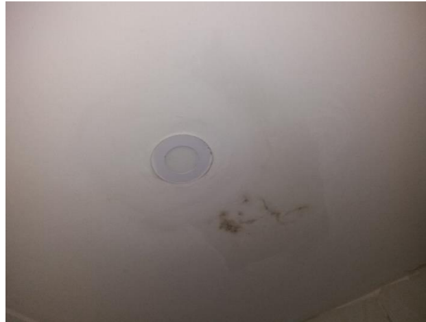
Figura 30. Manchas ocasionadas por filtraciones en las instalaciones.
