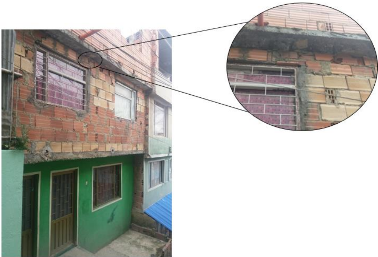
Figura 20. Detalle de mal proceso constructivo Fuente: Propia
