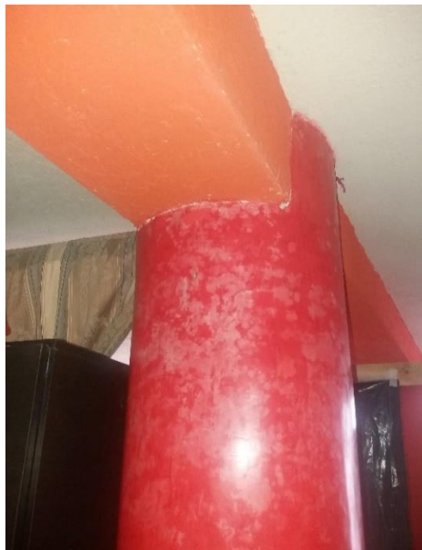
Figura 31. Eflorescencias por filtración de agua en anclajes
