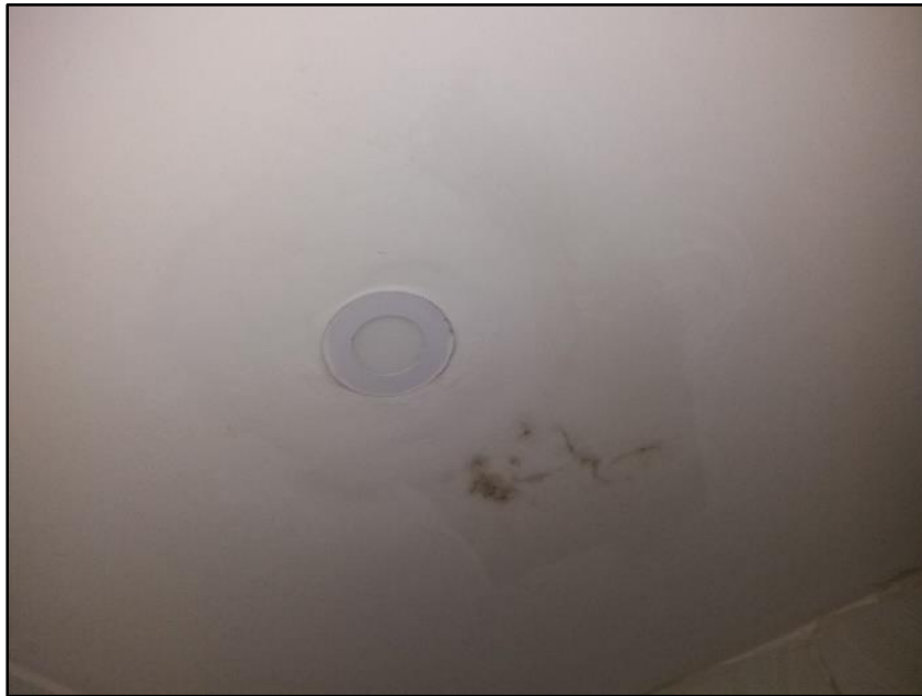
Figura 1. Manchas ocasionadas por filtración en las instalaciones. Fuente: propia
