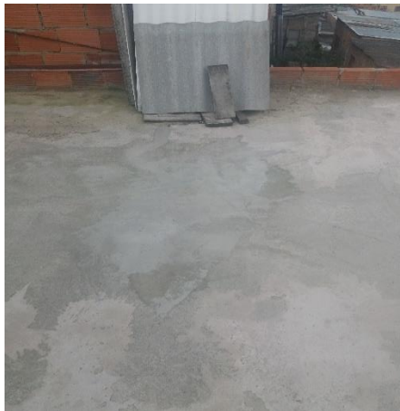
Figura 26. Impermeabilización deficiente a Fuente: Propia
