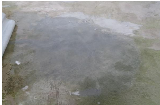
Figura 25. Empozamiento por mal manejo de pendientes en la cubierta Fuente: Propia.
