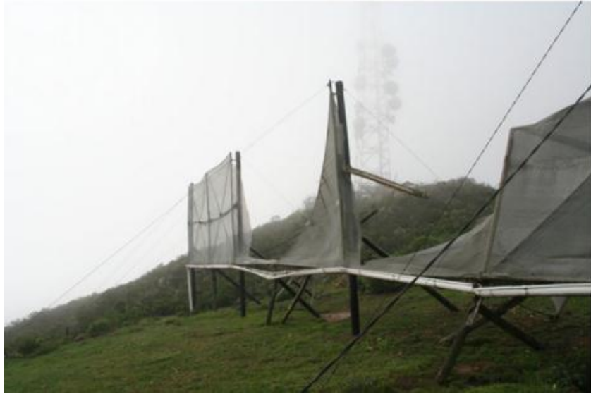
Figura 5: Colapso estructura colector Peña Blanca-Chile.
