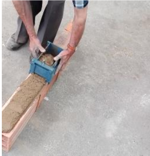
Figura 28: Aplicación de mortero de pega con el método del deslizador. Elaboración propia.
