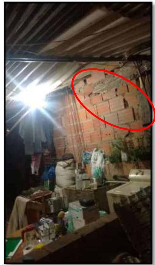
Figura 12. Estado de la estructura
