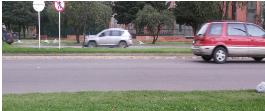
Figura 24- Estados de la señalización horizontal de la Carrera 50.
