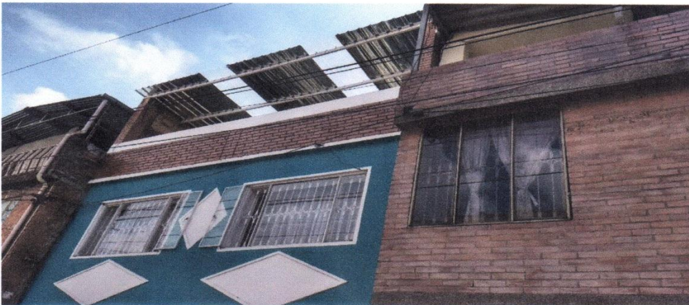
IMAGEN 2: fachada de la casa derecha, donde se evidencia ruptura del tejado, por donde cayó sujeto que huía de la Policía.
