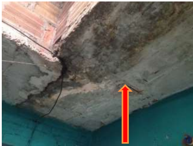
Foto 6. Elemento estructural sin estribos
