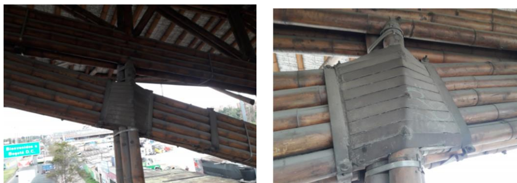
Foto 8, foto 9 , Estado actual de las estructuras, uniones platinas en puntos críticos de los cuatro costados sección 4
