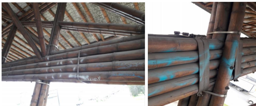
Foto 6, foto 7 , Estado actual de las estructuras superior y tipo de uniones presente sunchos y abrazaderas
