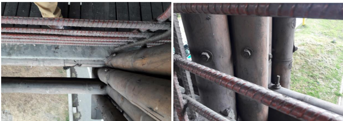
Foto 10, foto 11 , Estado actual de las estructuras, uniones estructuras de soporte con estructura de tirantes
