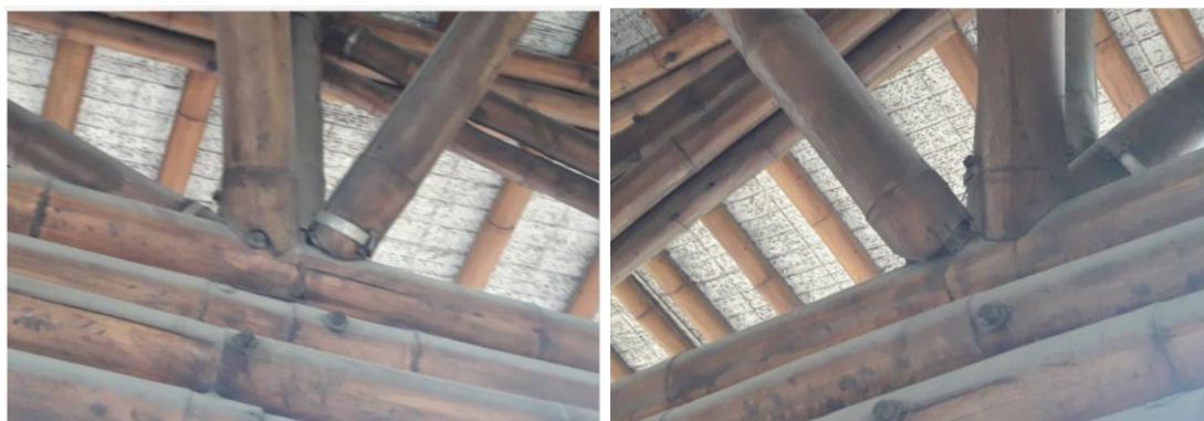
Foto 12, foto 13 , Estado actual de las estructuras, uniones tipo boca de pescado
