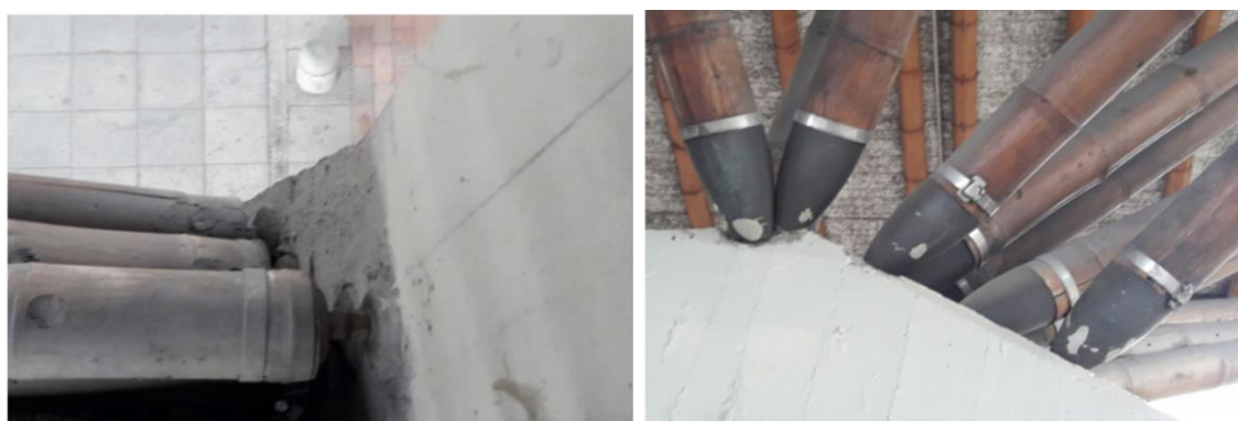
Foto 14, foto 15 , Estado actual de las estructuras, uniones articulares estructura de guadua a estructura de concreto
