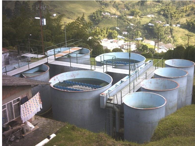
Figura No. 19. Filtros
