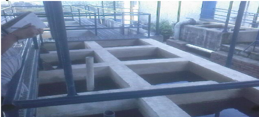
Figura No. 38. Proceso de filtración
