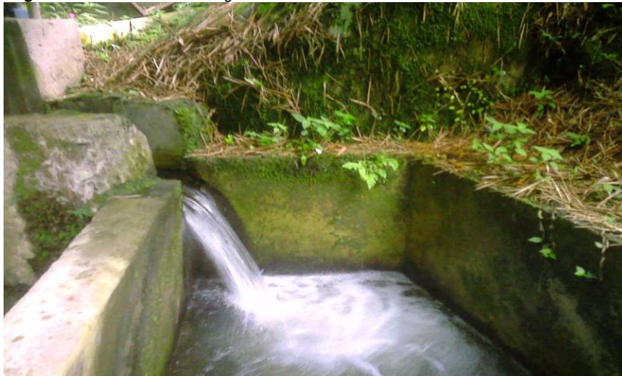
Fuente. Planta de tratamiento agua potable Sasaima Cundinamarca 2015
