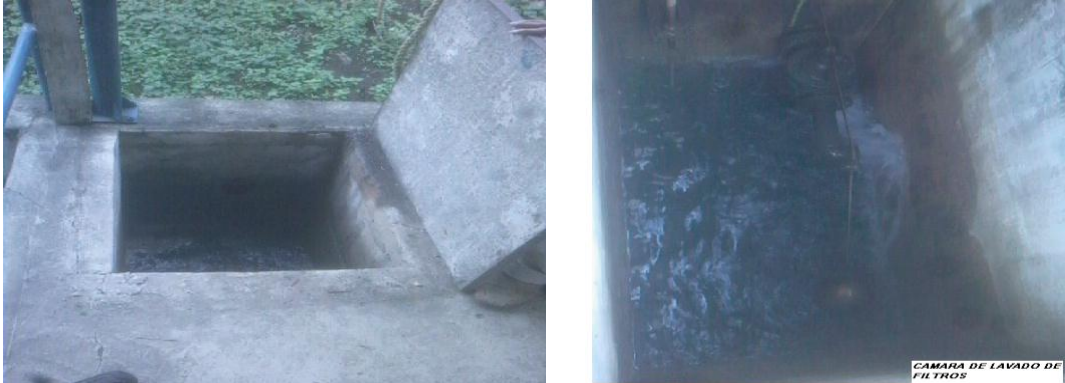
Fuente. Planta de tratamiento agua potable Sasaima Cundinamarca 2015
