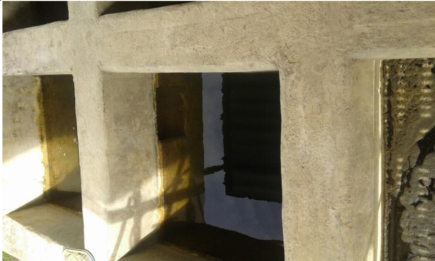
Figura No. 36. Floculadores
