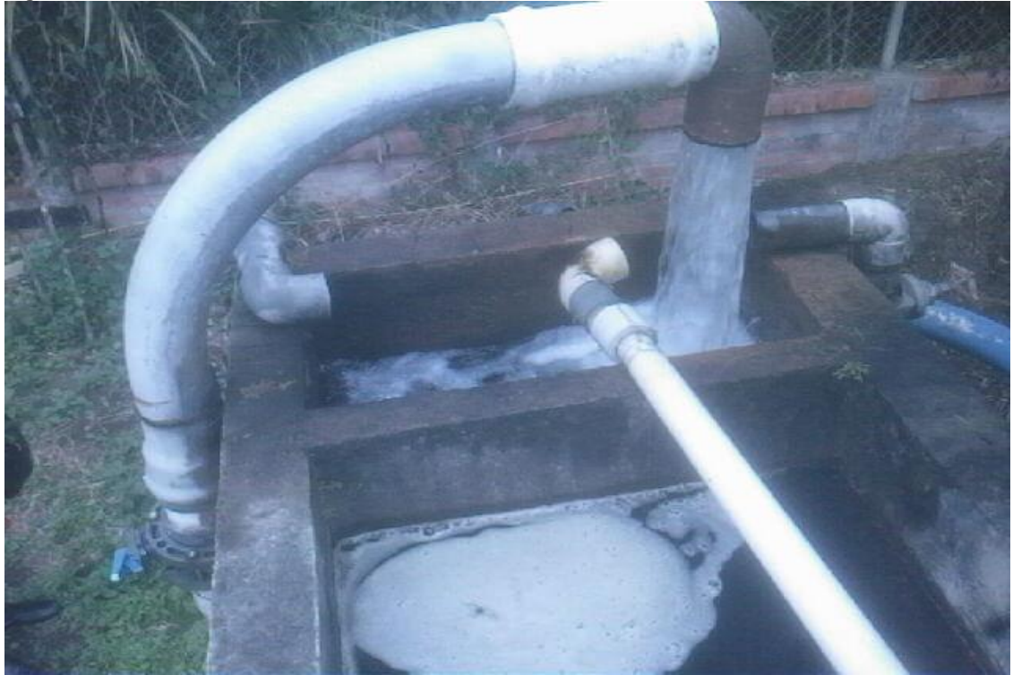
Figura No. 28. Desarenador
