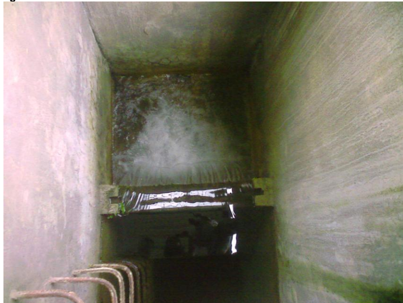
Fuente. Planta de tratamiento agua potable Sasaima Cundinamarca 2015
