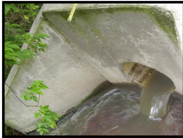
Imagen 18. Vertimiento del efluente en la PTAR laguna de oxidación
