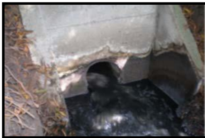
Imagen 17. Vertimiento del efluente de la PTAR RAP
