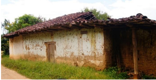
Tipología casa vereda reyes, la unión-Nariño Materiales: piso de tierra, adobe, madera, guadua y teja de barro.
