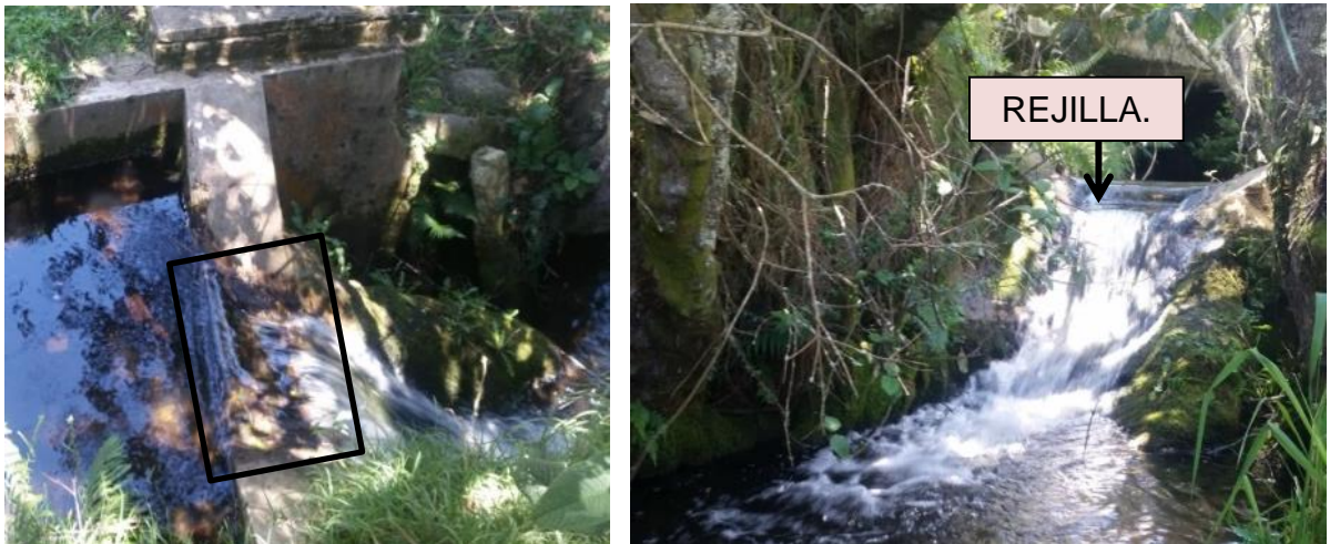
Figura 7. Punto de captación.
