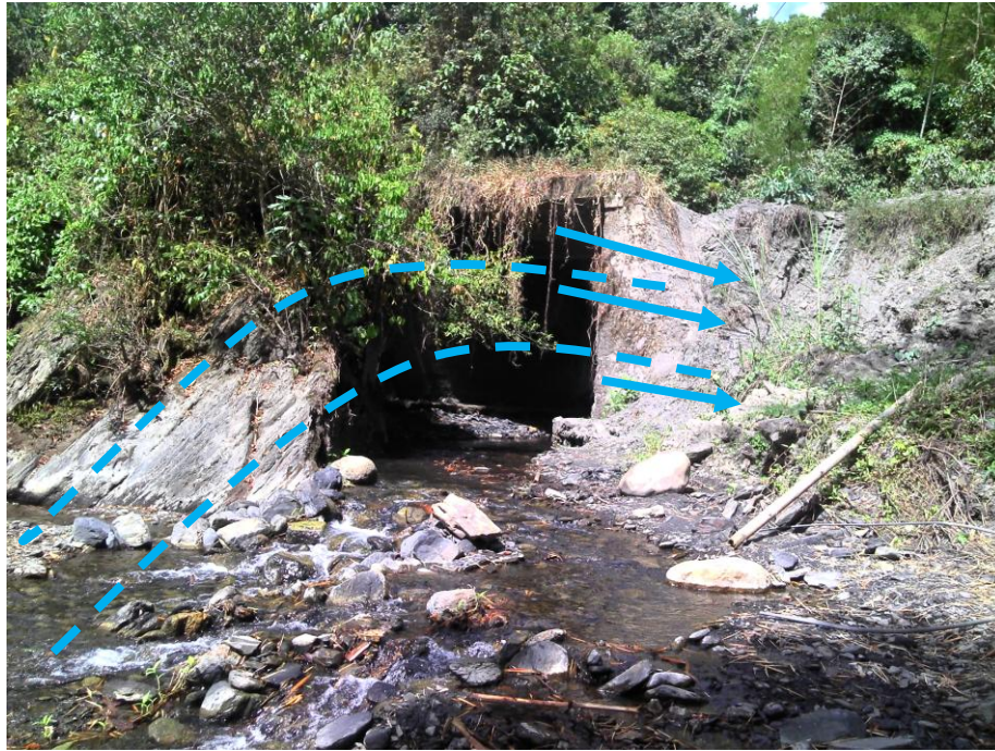
Fotografía 2. Líneas y dirección de flujo, impacto sobre el talud y deslizamientos posteriores.
