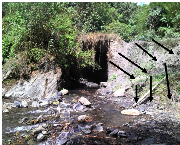
Fotografía 1. Pontón y deslizamiento de la banca
