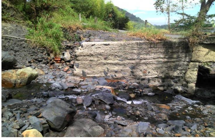
Fotografía 7. Exposición de las aletas, disgregamiento y pérdida de material
