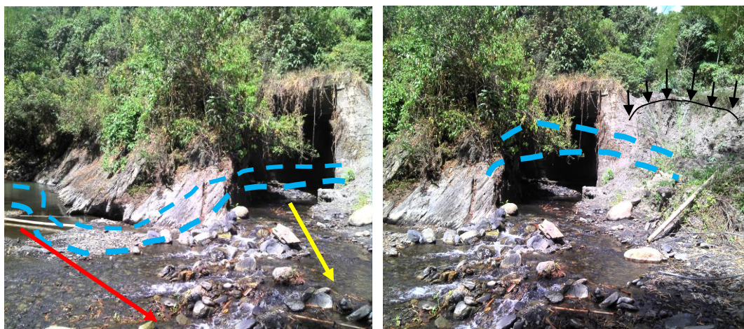
Fotografía N.6. Margen en roca sólida, el resalto y su efecto sobre el talud o la banca del estribo izquierdo del pontón. La línea roja indica la dirección del río, la línea amarilla indica la dirección de la quebrada.
