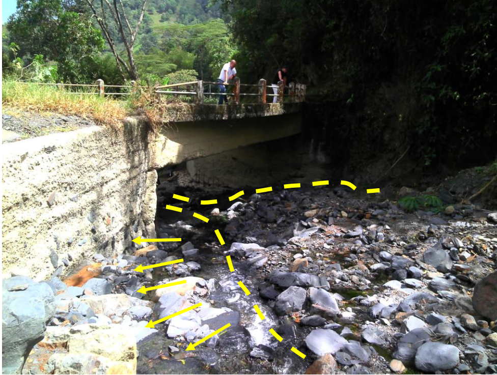
Fotografía 3. Puente en riesgo de colapso y obstrucción del cauce por la sedimentación de material.
