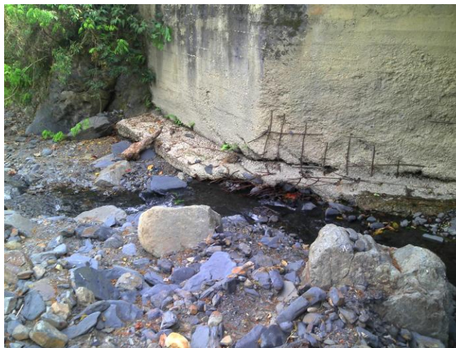
Fotografía 9. Socavación del material de los estribos. Exposición directa a las líneas de flujo
