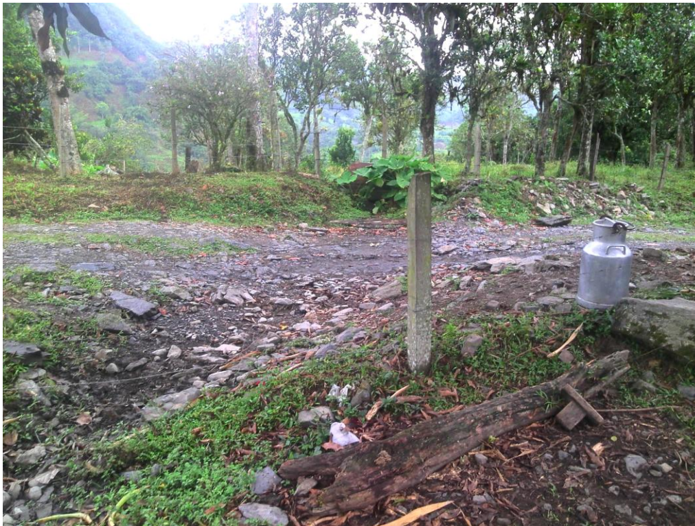
Fotografía No. 3 Canal de encausamiento para el rebose del cuerpo de agua. Nótese su reducida sección transversal cruzando ortogonalmente el tramo vehicular. Fuente propia
