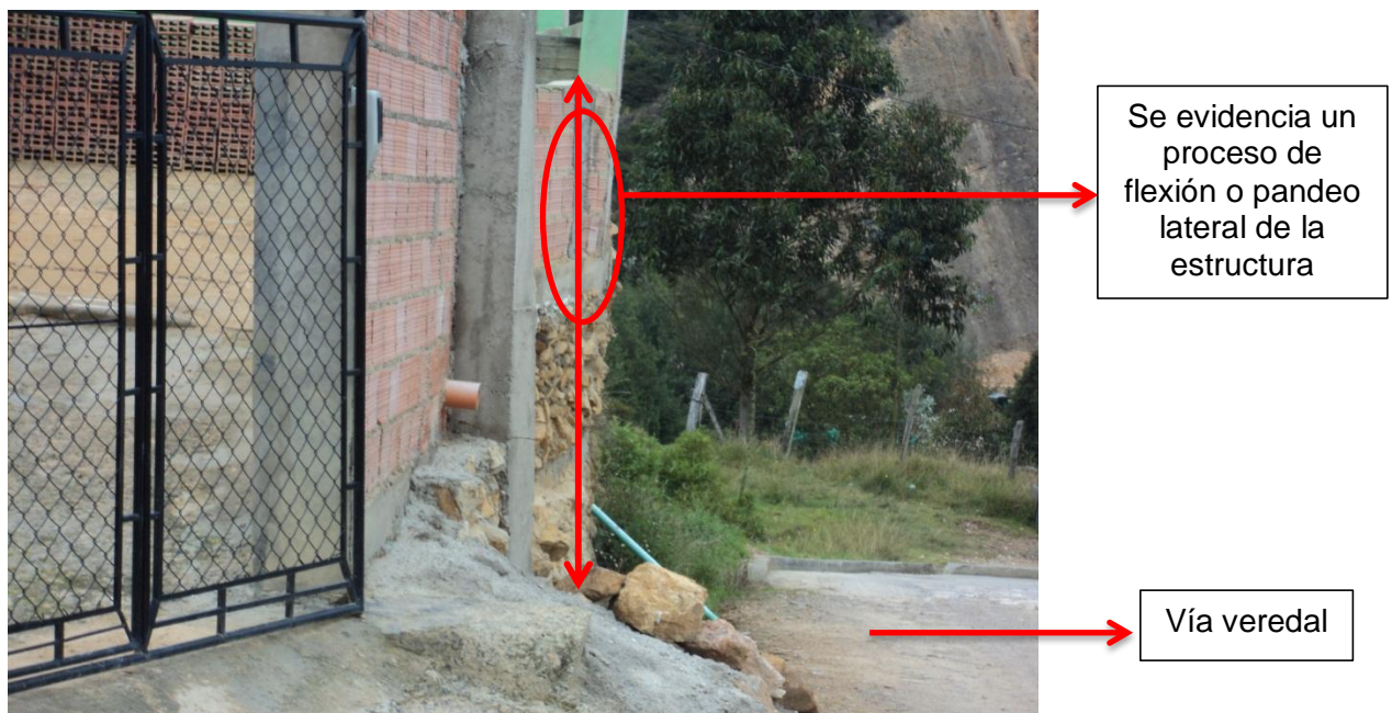
Foto 4. Pandeo lateral del muro
