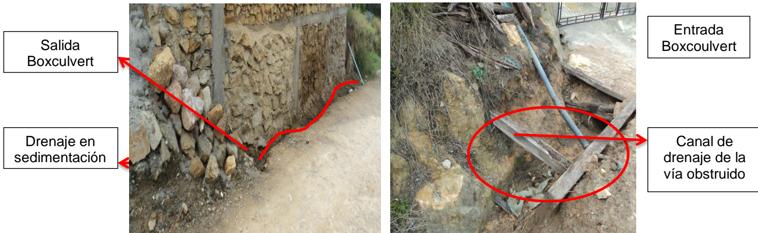
Foto 4. Sistema de Drenaje de aguas de escorrentía
